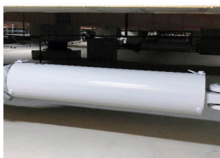
写真2 オイルダンパー
