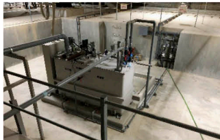
写真4 感染系統用排水処理装置
