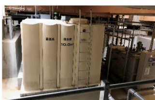
写真8 薬品系統排水処理装置
