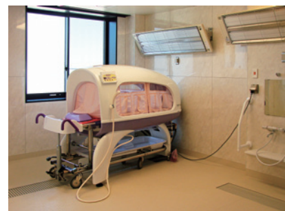
浴室・機械浴槽
