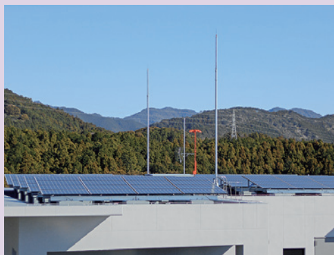
太陽光パネル
